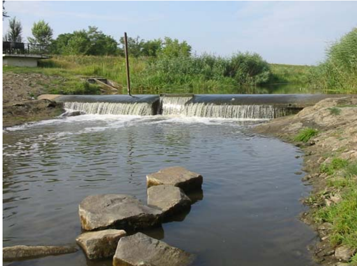
A Zagyva hosszirányú átjárhatóságát akadályozó keresztgát Jászberénynél (Harka Ákos felvétele)
